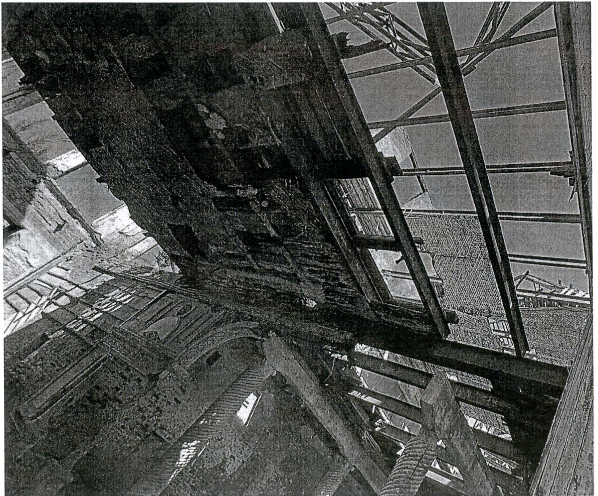
Фото 6 от 07.05.2025. Утрата перекрытий.
